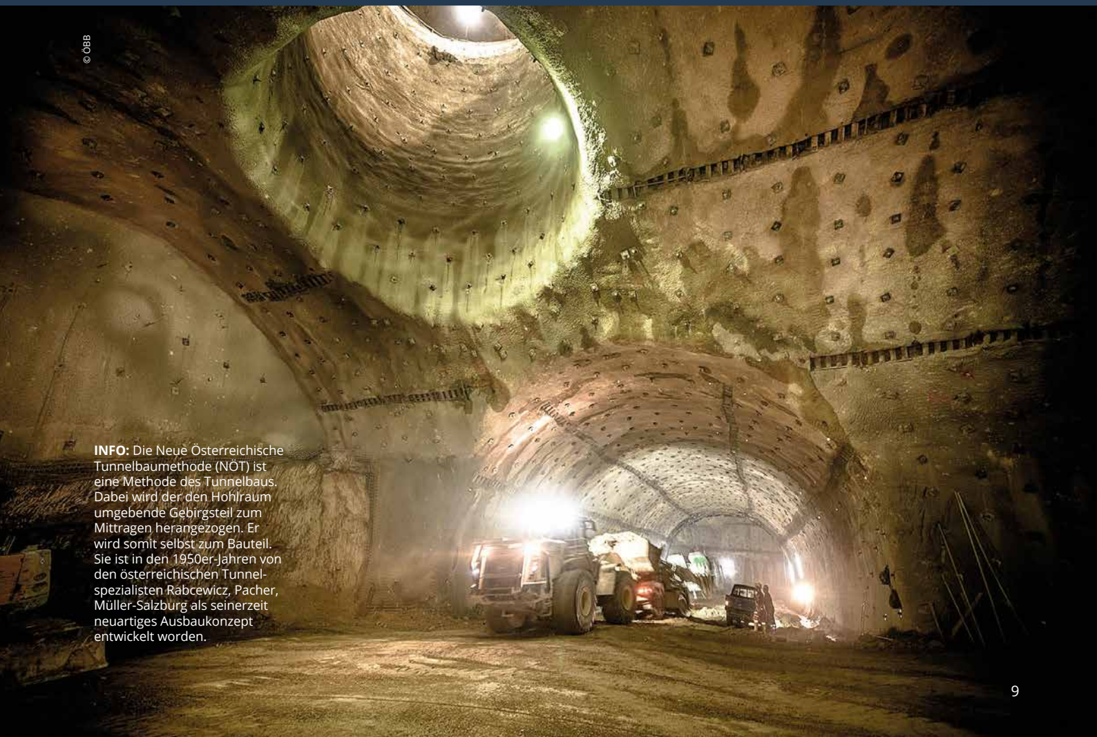
Schachtkopfkavernensystem in Göstritz
